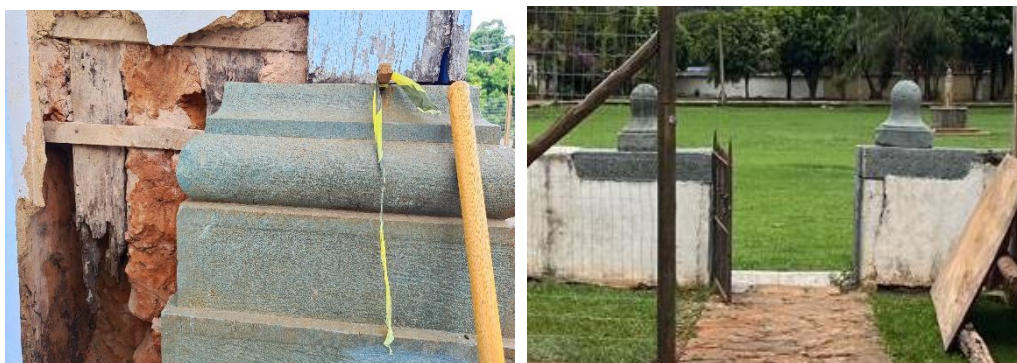
Cantarias higienizadas na fachada frontal e detalhes do muro no entorno da Igreja. Autoria: Francielle Ferreira e Natália Morita Data: 23/10/2024
