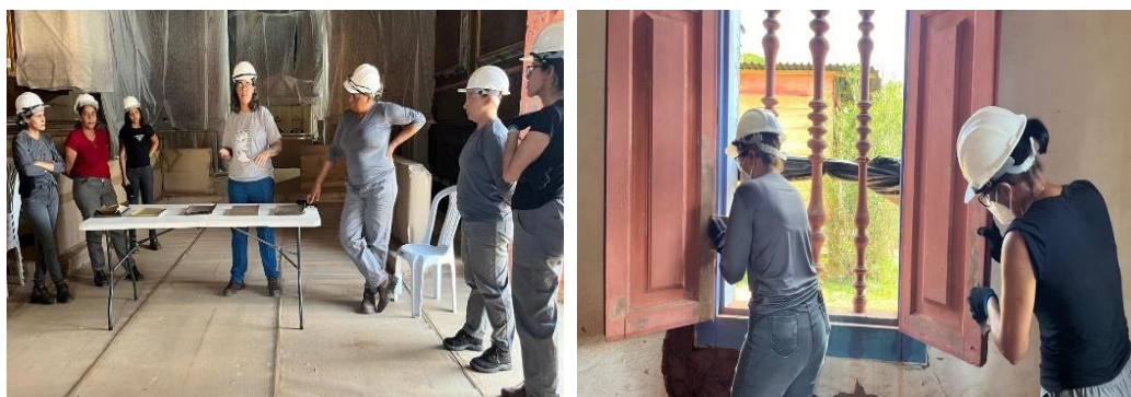
Equipe do Joaquim ministrando o módulo sobre remoção de pintura das esquadrias para os alunos membros da comunidade de Brumal Autoria: Natália Morita Data: 23/10/2024
