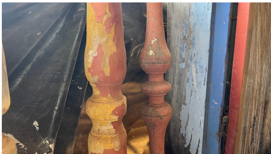
Pintura amarela abaixo da coloração vermelha nas balaustradas das esquadrias da fachada posterior. Autoria: Natália Morita Data: 23/10/2024
